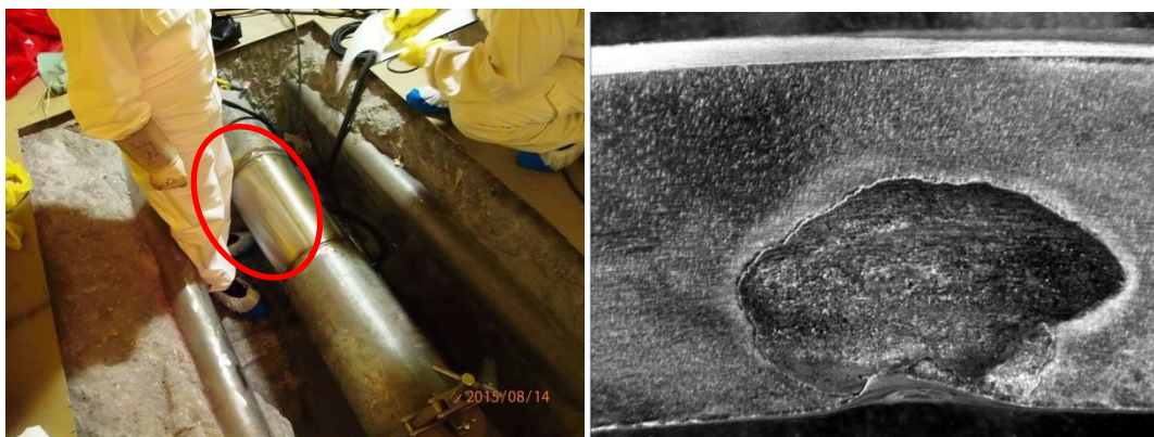
A 2. blokki hibás csővezeték a behegesztett új csőszakasszal és a korróziós eredetű hibahely keresztmetszeti képe
