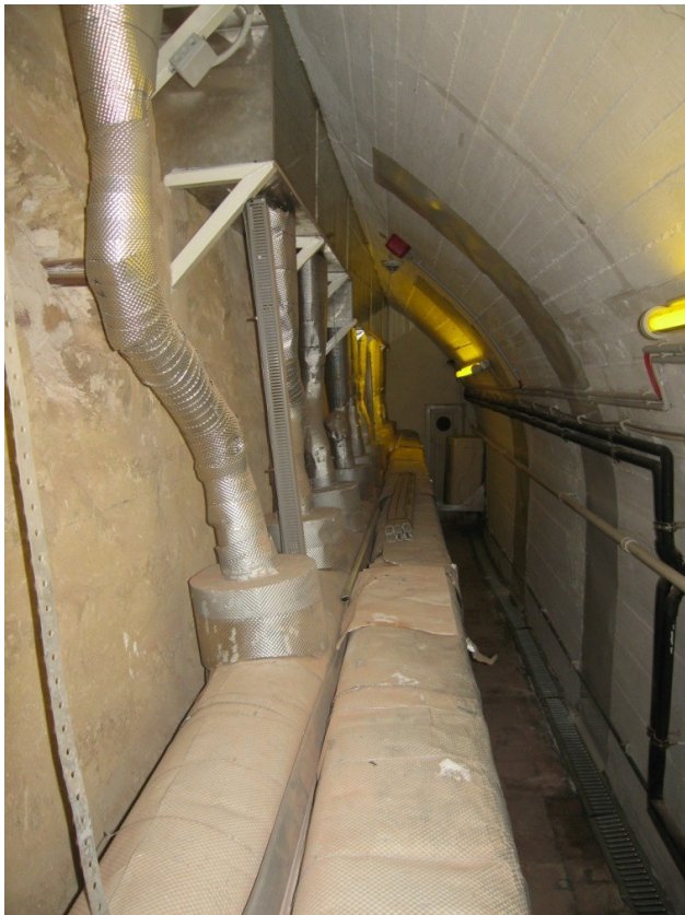
55. kép. A 12. sírépület gépészete (Fotó: Mezős Tamás) A klimatizált sírkamrát dobozként fogadja be a modern, szigetelt vasbeton építmény. A falképek megóvását garantálja a gépészeti rendszer.
