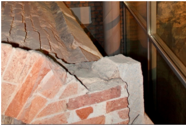
20. kép. Az 4. sírkamra boltozatának lefaragott Möller-féle kiegészítése és vasbeton megerősítésének részlete (Fotó: Janus Pannonius Múzeum)
