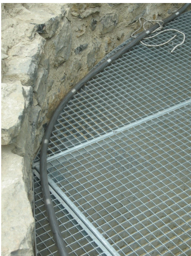
53. kép. A 11. sírípítmény elektromos hálózata. (Fotó: Mezős Tamás)
